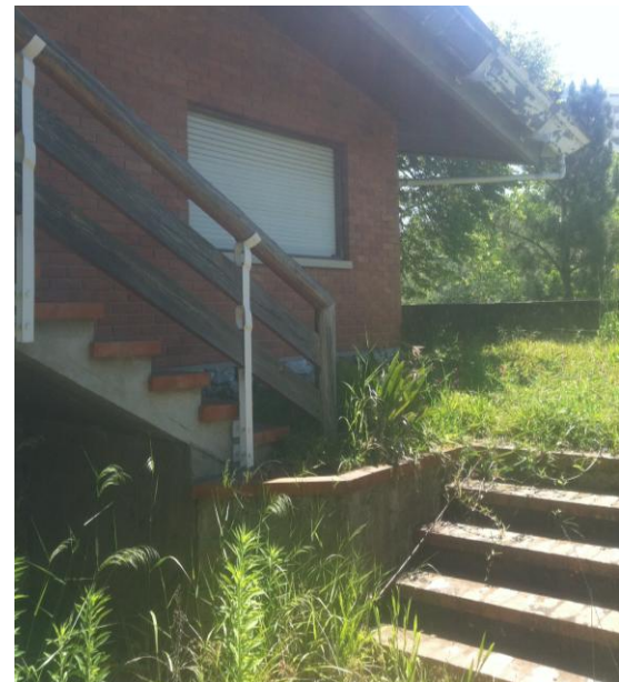
Fig. 77 – Escada de acesso à varanda e ao logradouro, situada no lado nascente da moradia.
