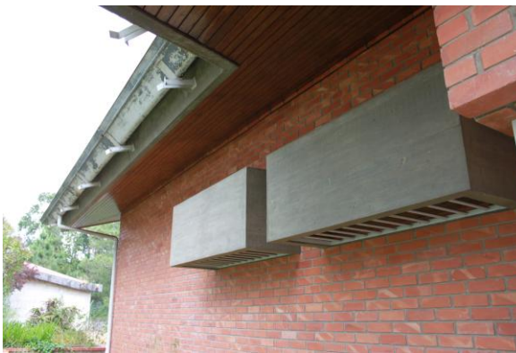
Fig. 72 – Volumes paralelepípedicos, destacados do paramento, por onde é feita a iluminação dos sanitários do lado norte. Forro de madeira do avançado da cobertura e caleiras que acompanham o beirado.
